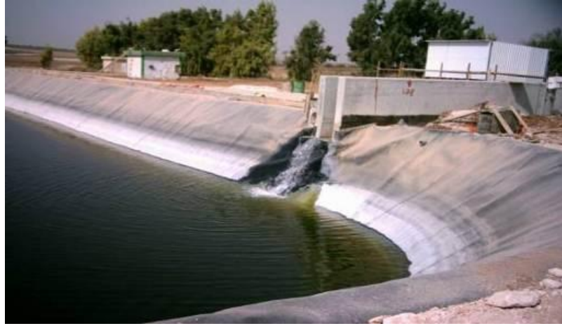
محطة معالجة مياه الصرف الصحي
